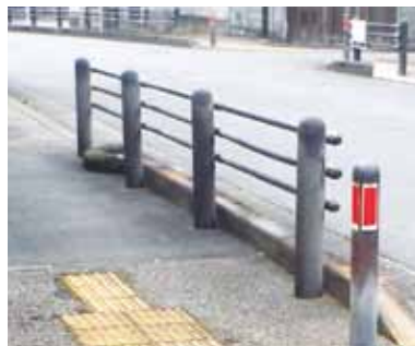
ガードパイプ
