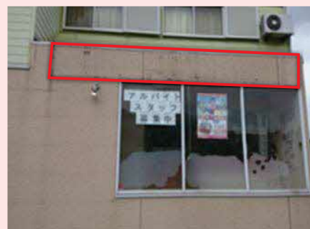
落下した後の壁面
