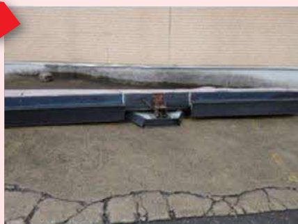
落下した欄間看板
