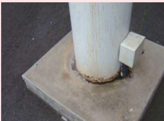
ポールの根元にサビが発生
