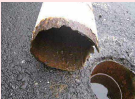
ポールの根腐れによる倒壊
