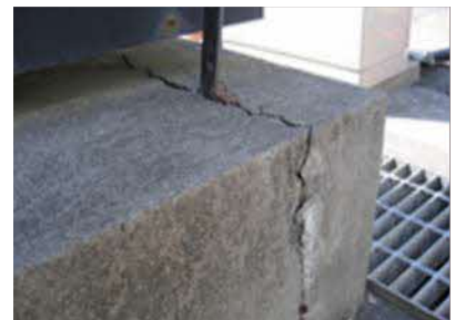
看板基礎のひび割れ
