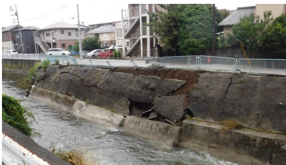
山王川の護岸の崩落
