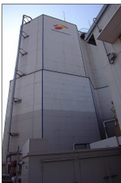
メタン発酵槽
