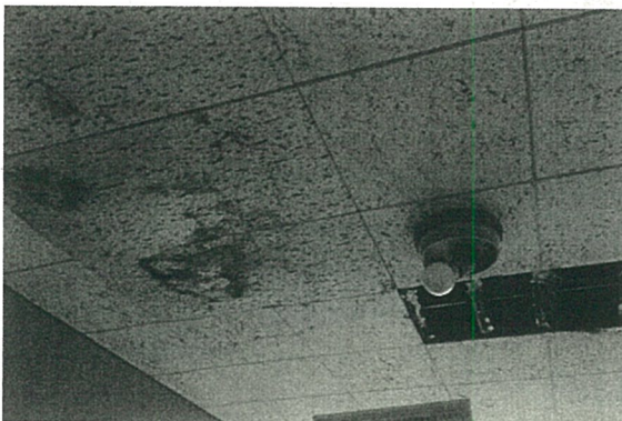
⑤雨漏りによる天井のカビ、はがれ
