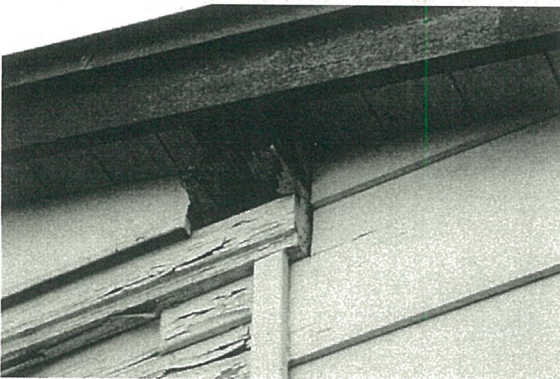
⑦木部の腐朽
