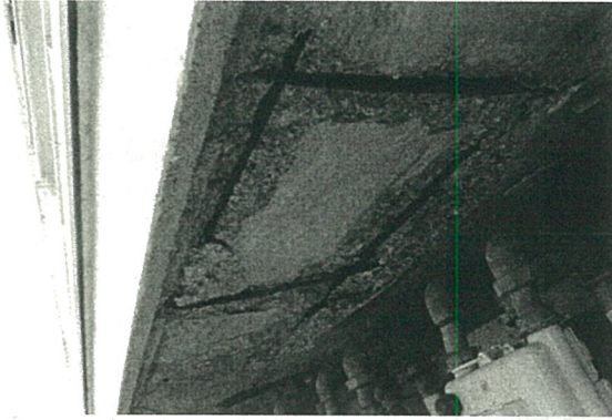
①鉄筋のサビによるコンクリートのはがれ
