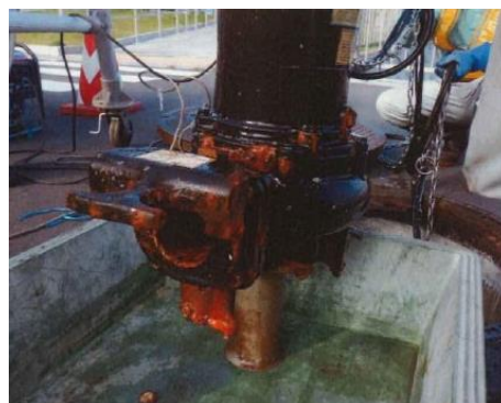
錆が出始めたポンプ設備の状況
