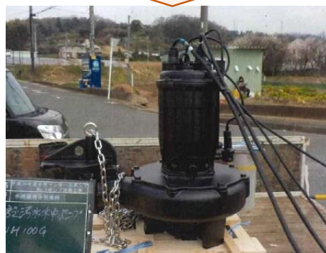
更新後のポンプの状況
