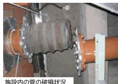
施設内の管の破損状況
