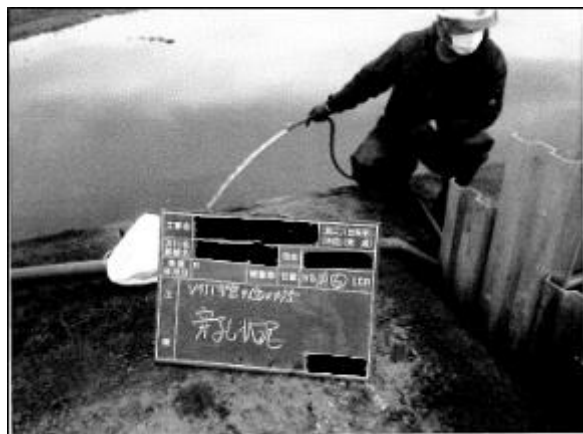
⑦放水状況
