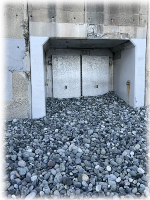
【波の影響で石が堆積している状況】
