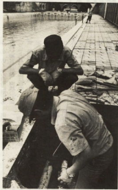
給水されると、すっかり私らしくなるが、まだ、給水管や排水管に故障がないか調べてもらう
