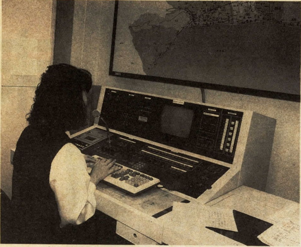
市役所内にある防災行政用無線の放送室
