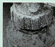
あばた状の腐食
