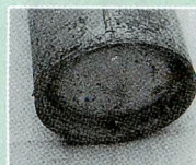
層状はく離の腐食
