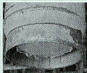
さびを落しても腐食の残るもの
