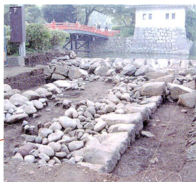
馬出門の北側の石垣。1段目から2段目にかけてが残されていました。内側には裏込めに栗石と呼ばれる川原石が詰め込まれています。
