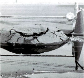
平成15年10月沖地震での液状化現象による被害例
