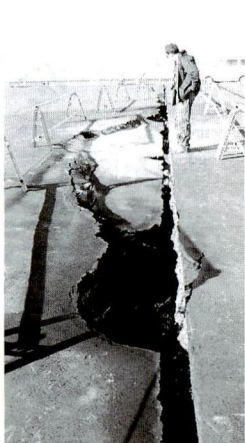
平成15年十勝沖地震の強い揺れによって、道路に亀裂と陥没がみられました。
