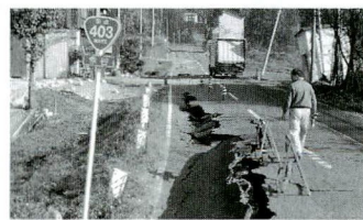
新潟県中越地震によって道路の陥没が起こりました。
