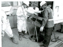
下水道管の詰まりを直すには多額の費用がかかります。
