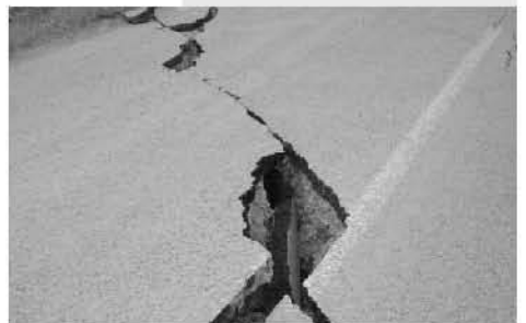
道路は地割れを起こし、通行止めに
