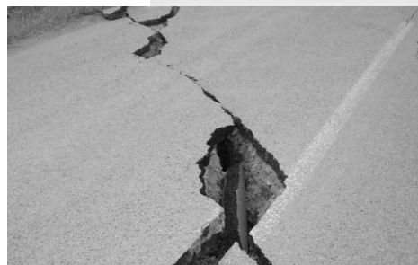
道路は地割れを起こし、通行止めに
