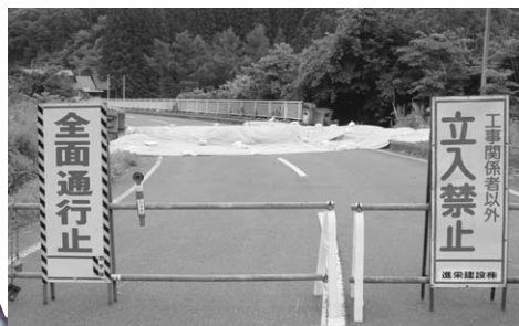
橋の手前で路面が隆起し、ブルーシートに覆われる
