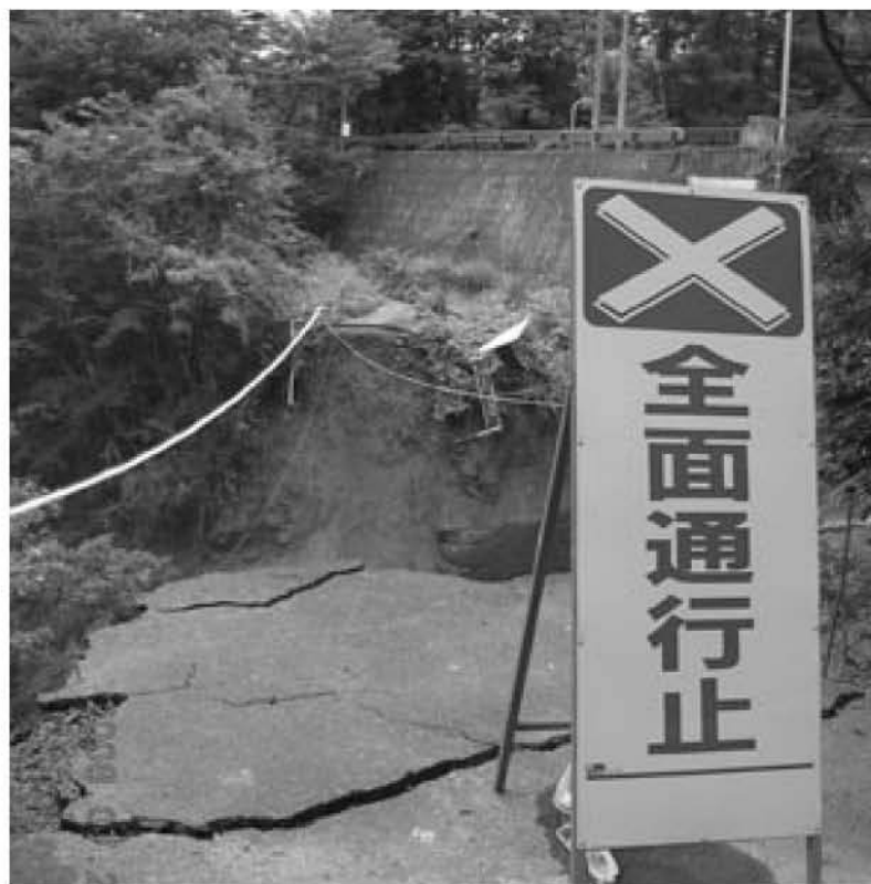
地滑りによって閉ざされた道路(岩手・宮城内陸地震にて)
