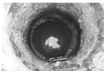
硫化水素で腐食されたマンホールの内部
