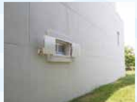
▲窓開口部の閉塞
