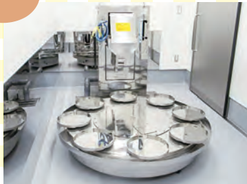
▲ (図⑦) 残菜処理室(残菜を粉碎し、脱水して減容する機器)
