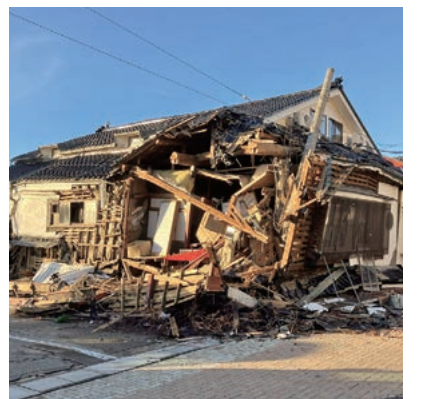
▲令和6年能登半島地震で倒壊した木造住宅 (県提供)
