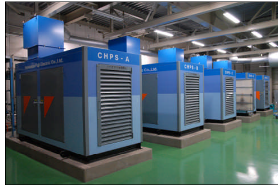
写真6 バイオガス利用設備 発電機 (中空知衛生施設組合)
