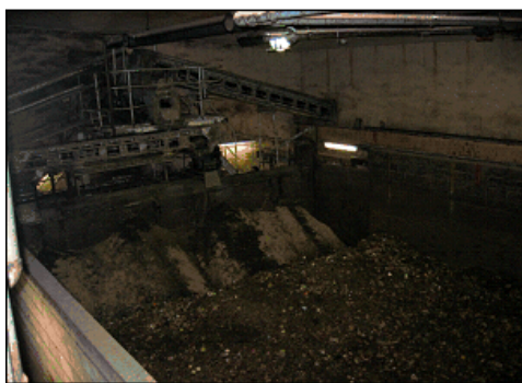
一次発酵槽に生ごみ・畜ふん・糞殻の3原料が投入され、15日かけてパドルとよばれるブレードで攪拌発酵されます。
