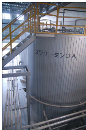
スラリータンク（可溶化槽）
