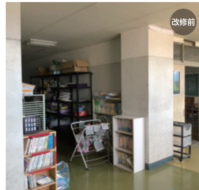
各階に教材用のスペースが複数あり、いずれも整理すれば余剰スペースが確保できる広さであった。また一部の教材室には扉がなく廊下から雑然とした様子がみえるのも改善する必要があった。
