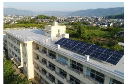
太陽光発電設備(曾我小学校)
