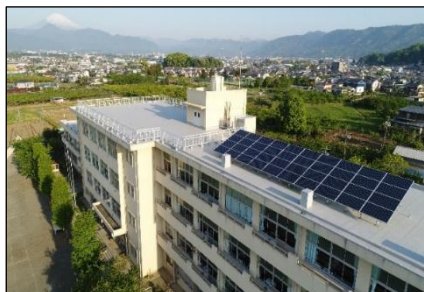
市内小学校に設置した太陽光パネル
