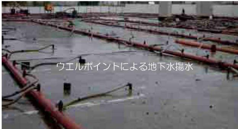
図 8-12 地下水揚水の概況写真
