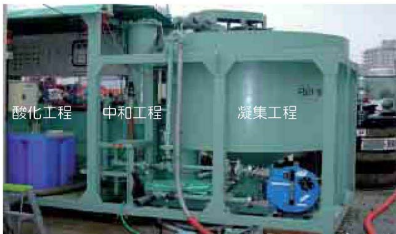
図 8-13 酸化、中和、凝集装置の概況写真
