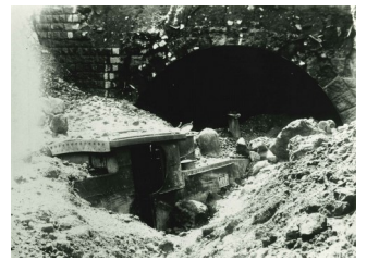
トンネル出口での土砂災害
