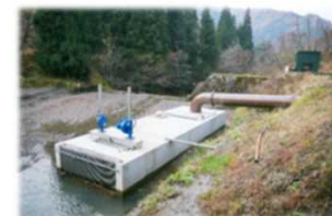
小水力発電施設
