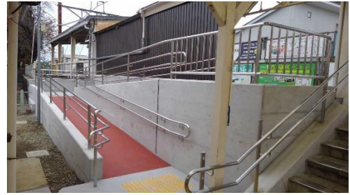
大雄山線井細田駅でのスロープ整備等(令和4年度実施) (国と市から鉄道事業者に対して整備費の一部を補助)
