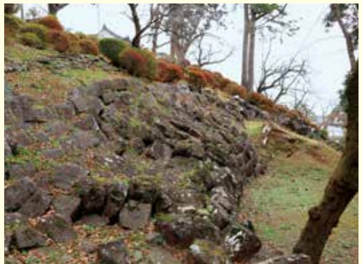
写真28 関東大震災で崩れた本丸石垣
