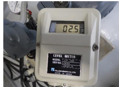
水位計設置状況
