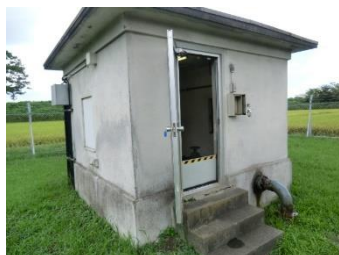
ポンプ室更新前
