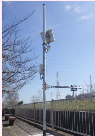
情報伝達手段の高度化 (河川氾濫災害予測システム河川カメラ)
