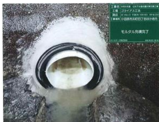
可とう継手の設置状況
