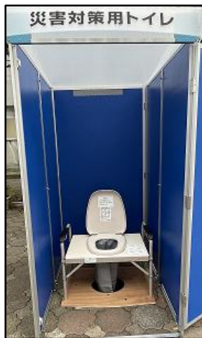
下水道本管直結型マンホールトイレ
