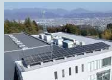
■ 市施設に設置されている太陽光パネル
