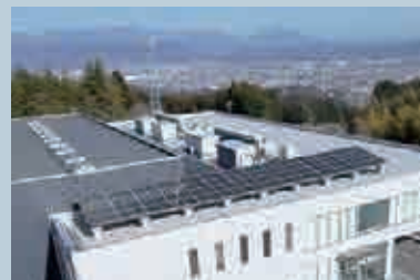
■ 市施設に設置されている太陽光パネル
