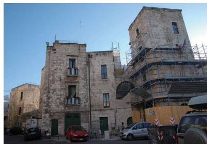
建物の修復は都市再生の重要な手段(足場が掛けられ改修工事が行われている)
