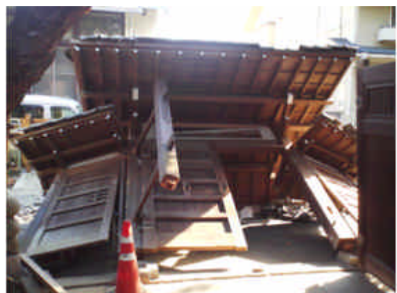
【南門内側より（倒壊直後）】
